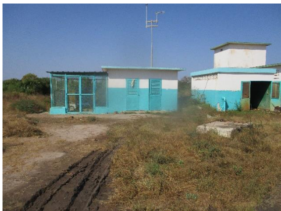
Forage F1+station de pompage de la SDE
