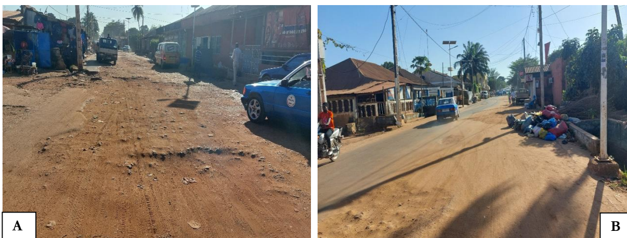
Photos 4: Vues partielles du tronçon de la Rue Plubl-Santa Luzia (A) et (B)/Janvier 2023.
