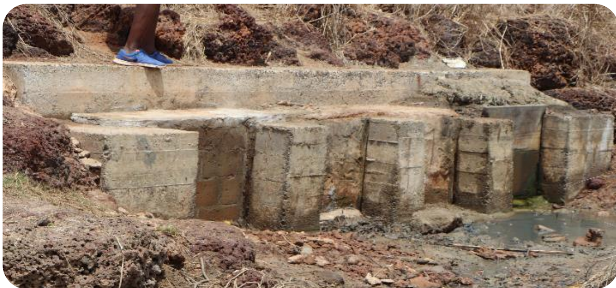
Dégradation des valves, Dorset, Biombo
