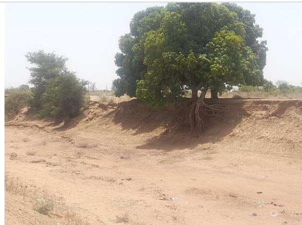
Berge dégradée à Ségala (à côté du Pont)
