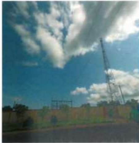
Photo 21: Sous-station de Dabou 90Kv
