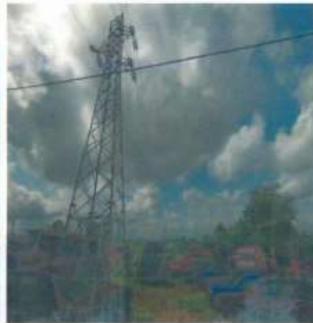
Photo 22: Lignes de transmissions et pylônes existants de la sous-station de Dabou
