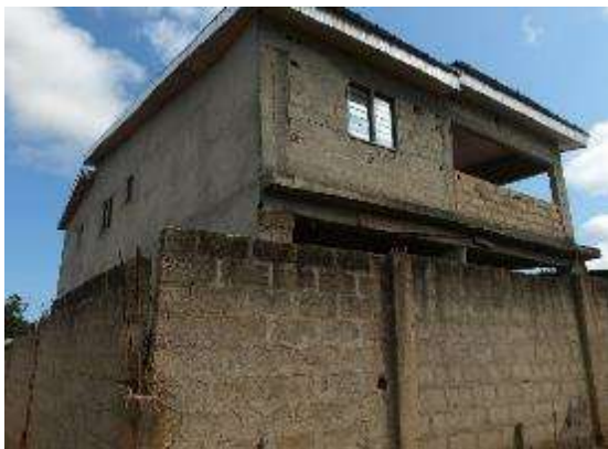
Maison d'habitation à Dabou qui tombe dans l'emprise, entre les pylônes 6 et 7 (photo ERM prise le 24 mai 2023)
