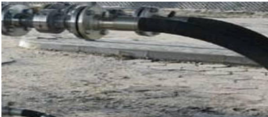
Figure 7: Poste de chargement et de déchargement de camion GPL
