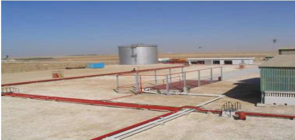
Figure 11: Dispositif de lutte contre incendie de KAMA-CI
