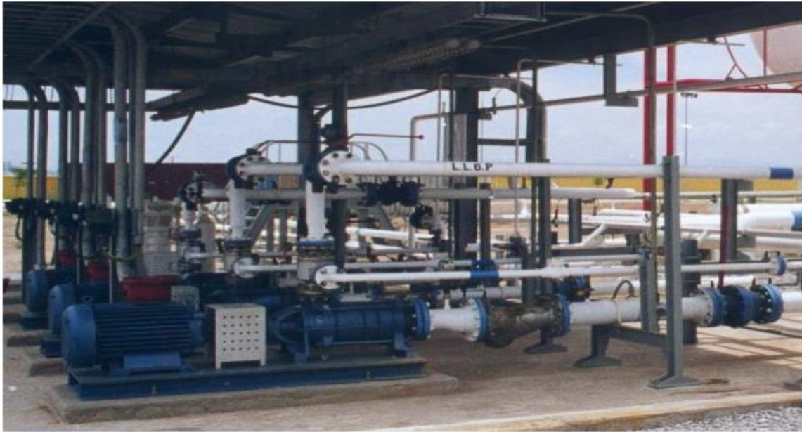
Figure 4: Hall d'emplissage de KAMA-CI SA
