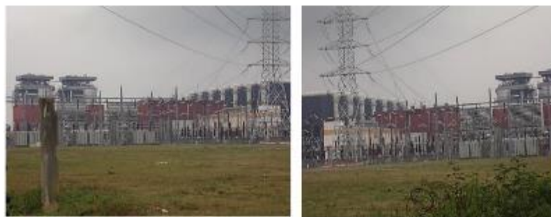
Figure 5: Centrale thermique d'AZITO dans la commune de Yopougon
