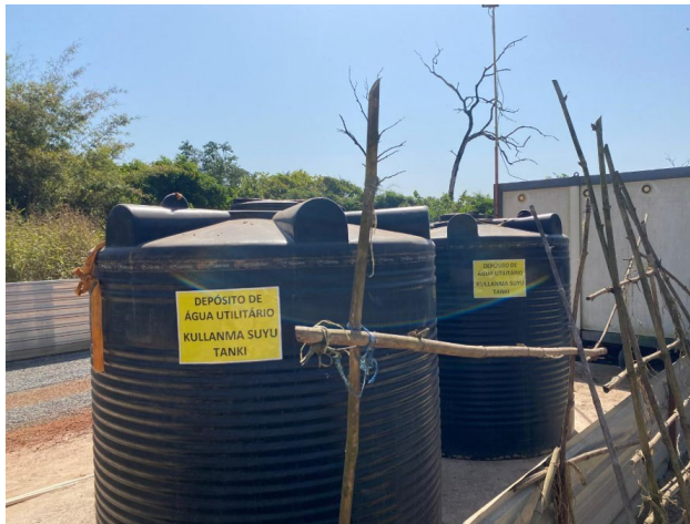
Figure 3-11 Réservoirs de stockage d'eau (Sustain Africa, 2025)
